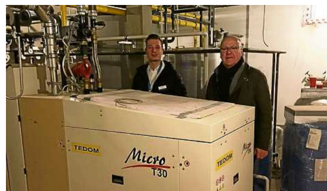
Hartmut Thede (r.), Leiter der Projektentwicklung, und Vertriebsmitarbeiter Philipp Wilski zeigen das Blockheizkraftwerk im Keller.
